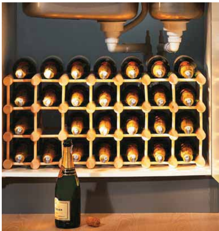
Vattenlåset tar inte så stor plats i skåpet.
